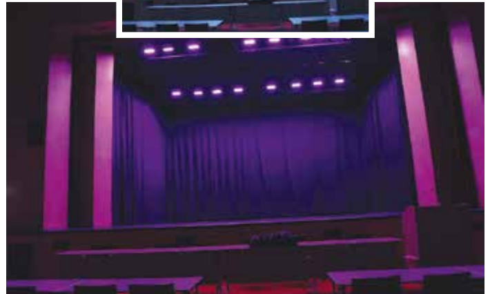
Kammersaal – Umstellung der Bühnenbeleuchtung auf LED (Licht emittierende Diode): Stromeinsparung 8.000 kWh/a (76 %)
