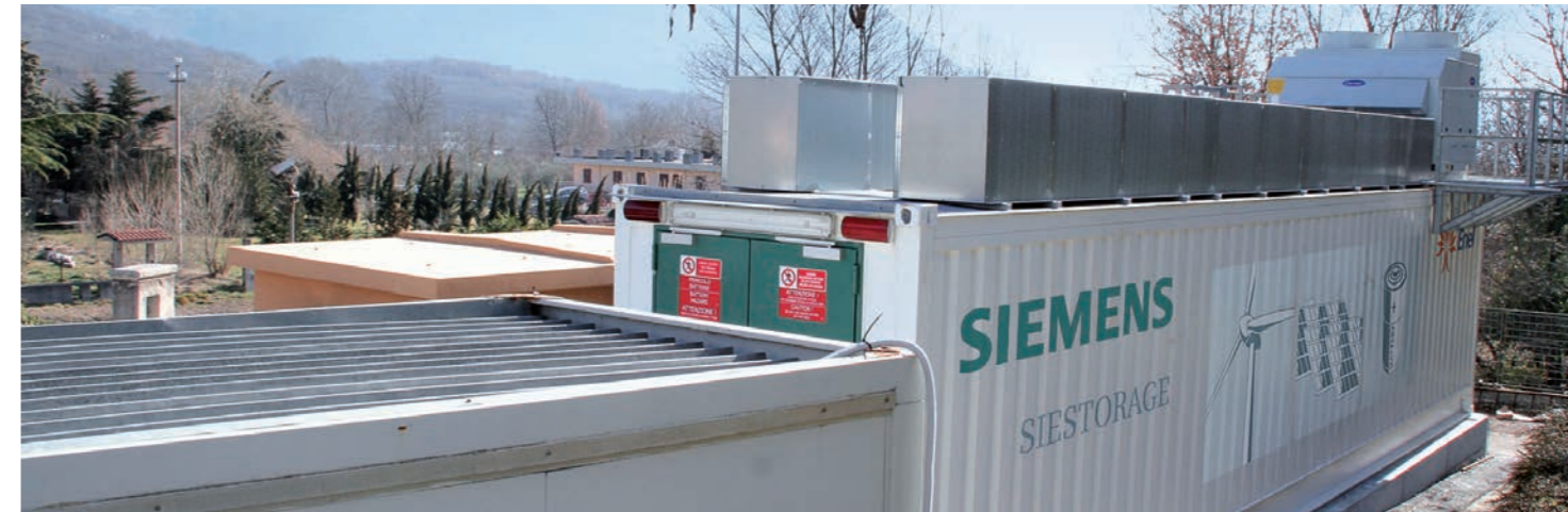
ENERGIESPEICHER stellen eine unterbrechungsfreie Versorgung sicher.
